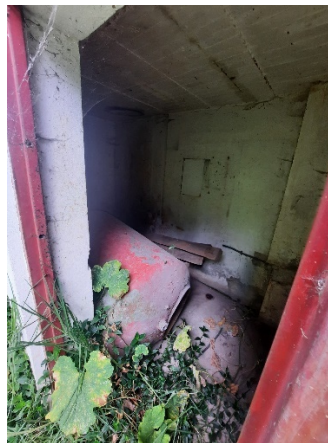
Foto No. 4 Vista interna cuarto de maquinas
